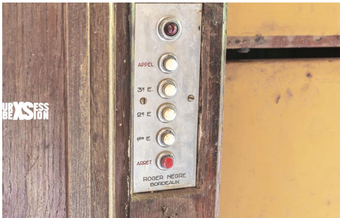
Figure 12 : Photographie du monte-plat, Château de Mont.
